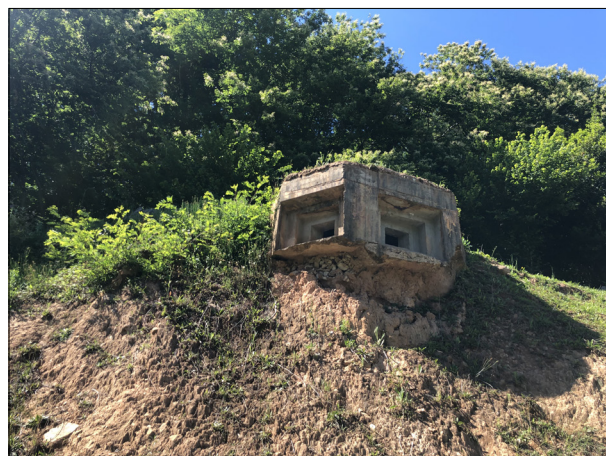
FIG. 17. Fortificación en riesgo por la ampliación de la carretera en el sector de Irún, Guipúzcoa. Fotografía del autor.
